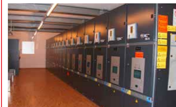
Mess- und Einspeisestation
