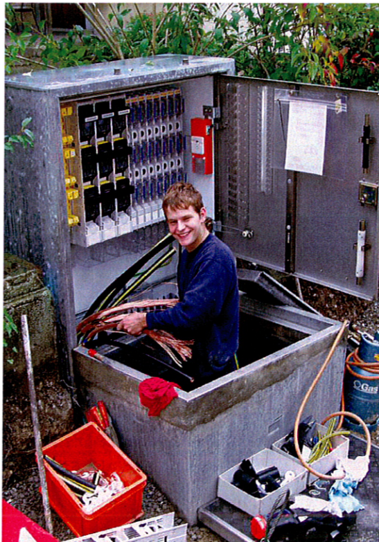
Raphael Stauber, Verkabelung Verteilboxe
