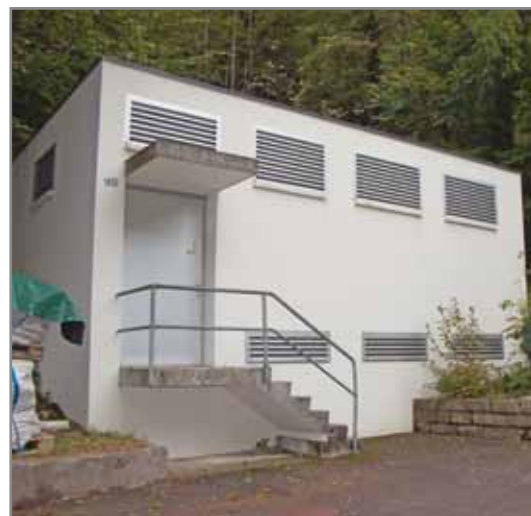
Neues Erscheinungsbild TS Tannertobel mit neuen Druckentlastungsgittern und neuen Trafo-Lüftungsgittern
