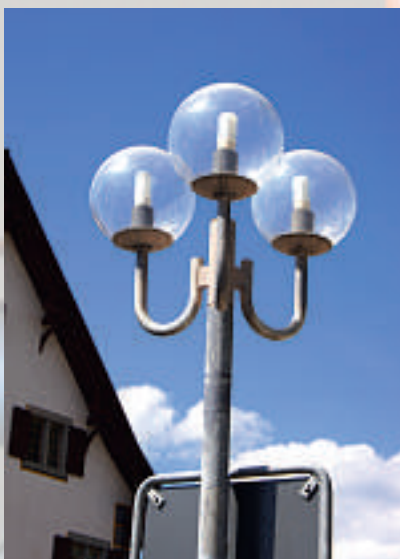
Herkömmliche veraltete Leuchte
