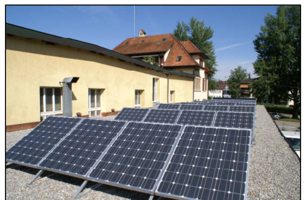
Komplette Anlage auf dem GWR Gebäude
