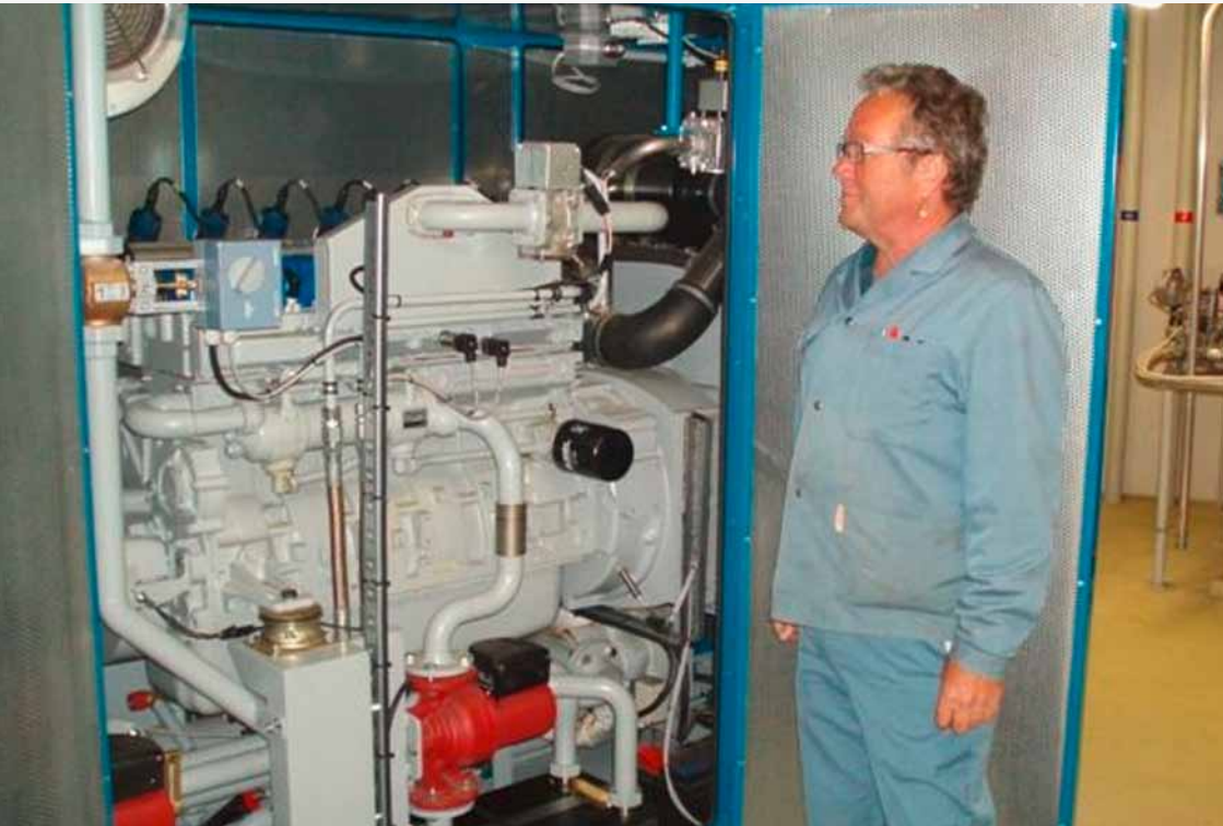
Blockheizkraftwerk mit Klärwerkmeister Hansruedi Bosshard beim Kontrollgang.
