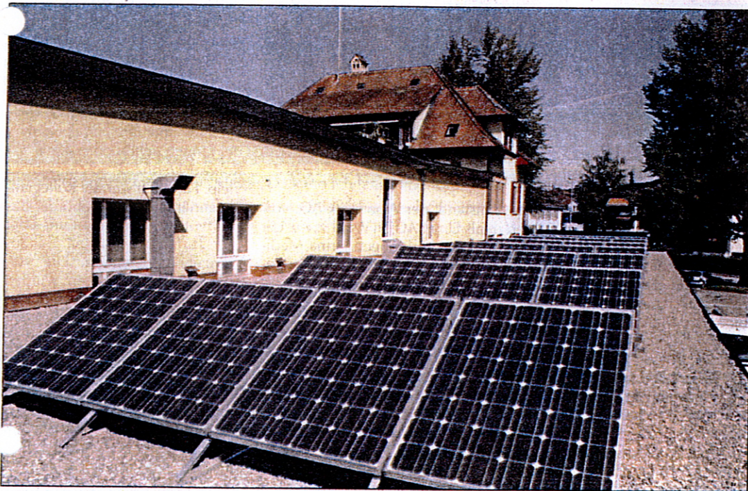
Photovoltaikanlage auf dem Dach der Gemeindewerke.
